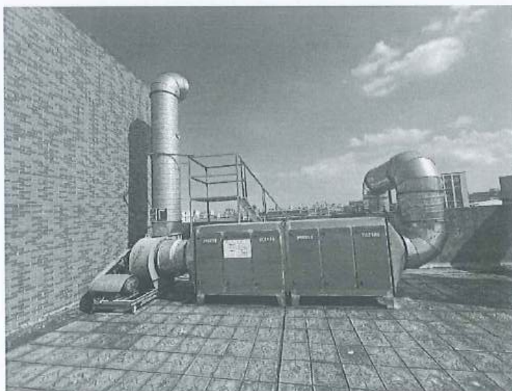
图4.1有机废气治理设施图
