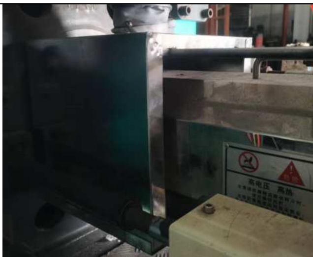
图 4-1 项目注塑废气集气罩图片
