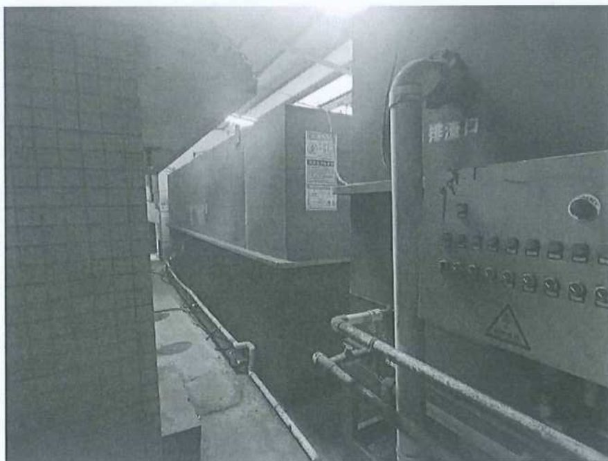
图 4.2 废水治理设施设施图
