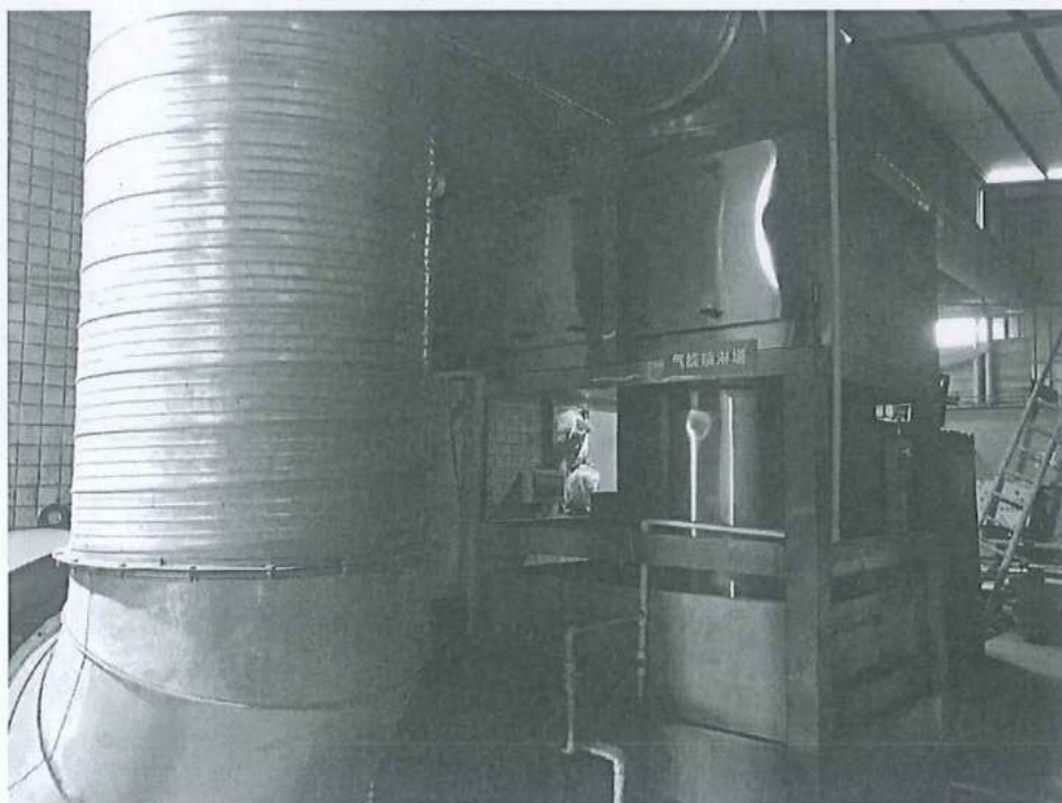
图 4.6 喷粉粉尘气旋喷淋塔治理设施图
