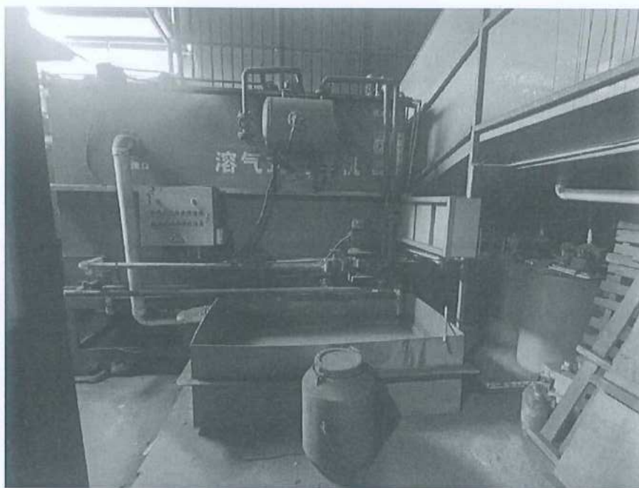
图 4.3 废水治理设施设施图
