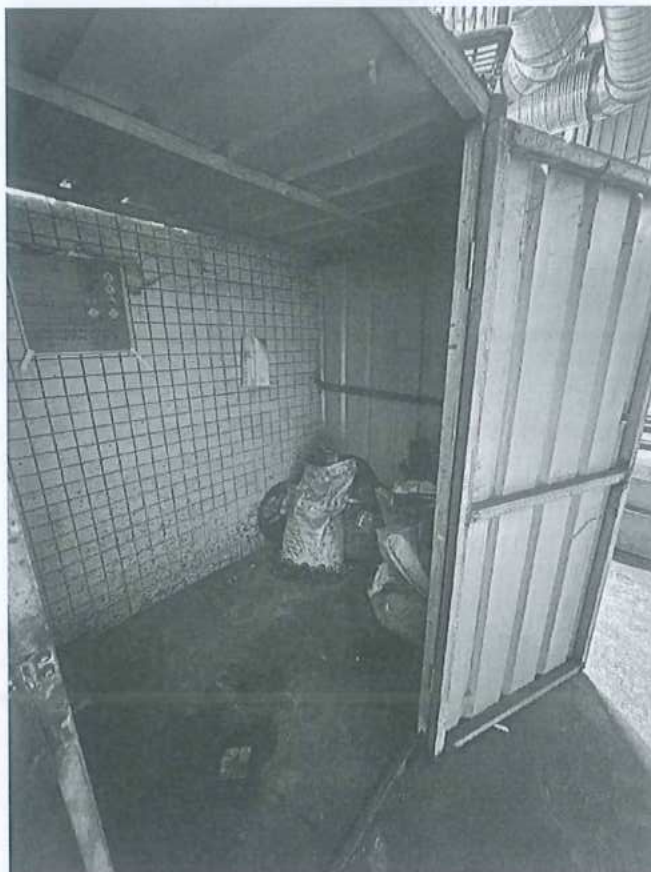
图 4.4 危废贮存仓内部图
