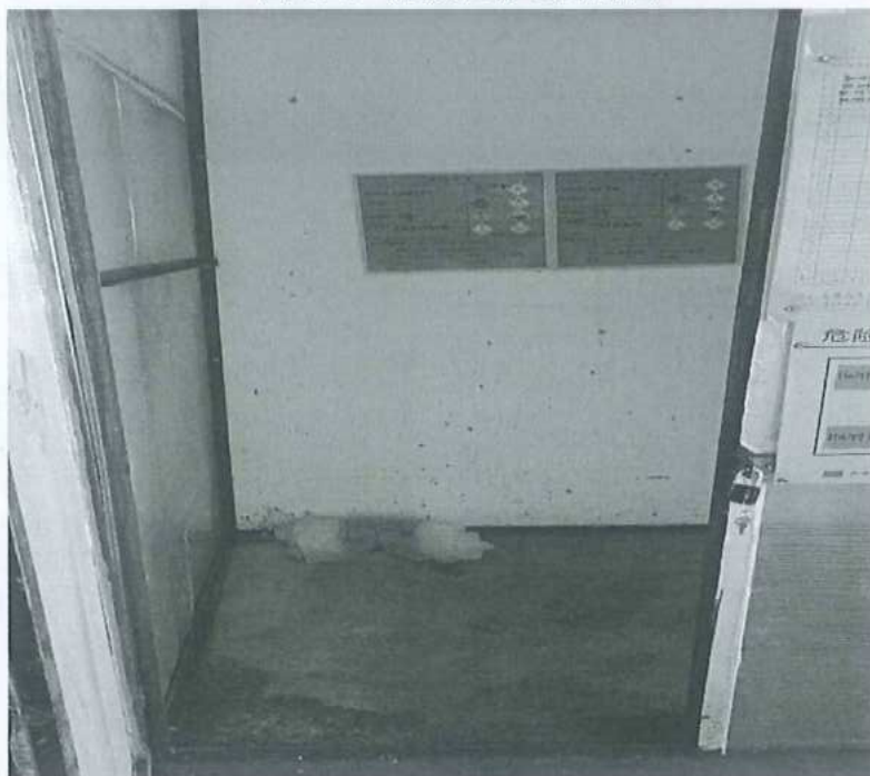
图 4-5 危废贮存仓内部图
