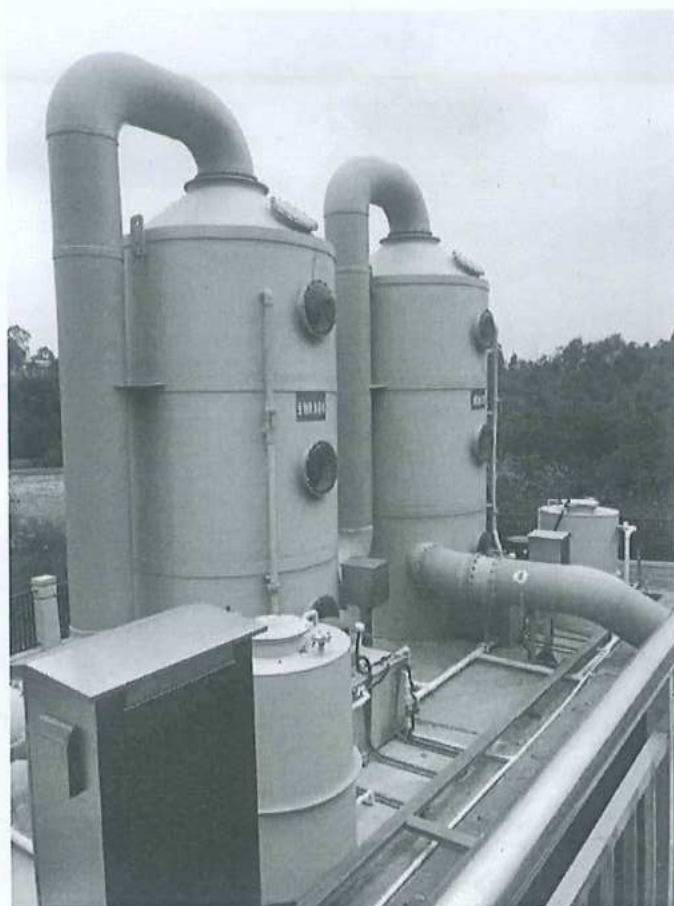
图 4.2 一期废治理设施现场情况图
