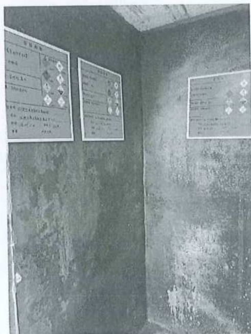
图4.3危废间内部图
