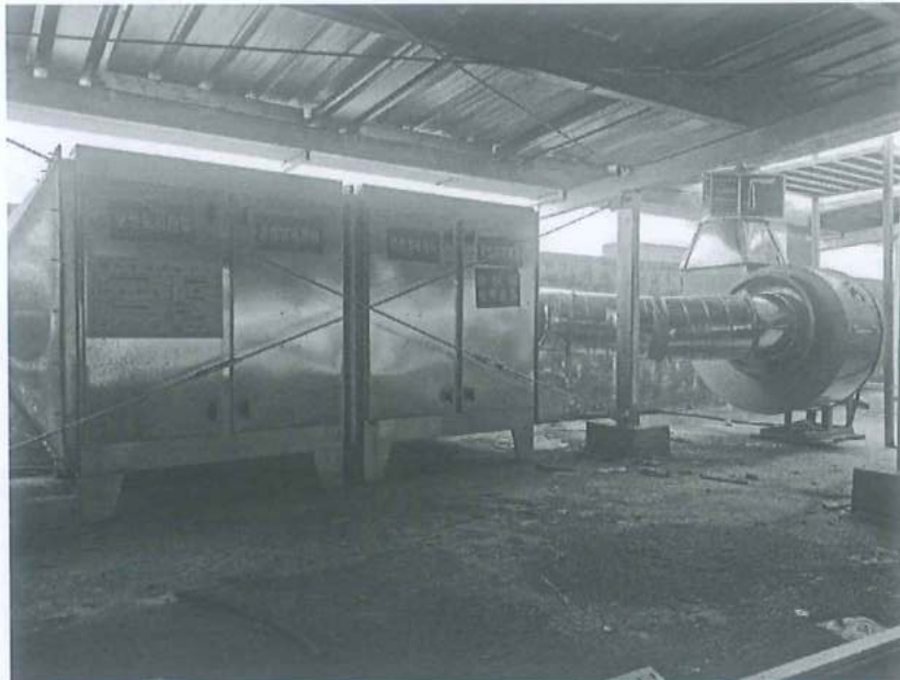
图4.1有机废气治理设施图
