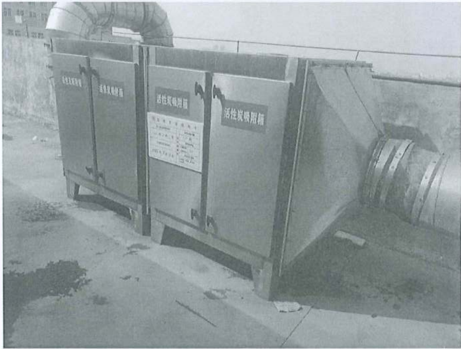
图 4.3 正极涂布烘烤 NMP、注液、清洗有机废气治理设施图
